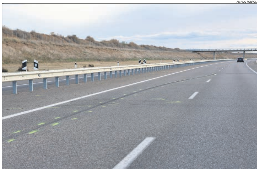
Vista del punto donde tuvo lugar el accidente el domingo en la A-14 en Torrefarrera.
