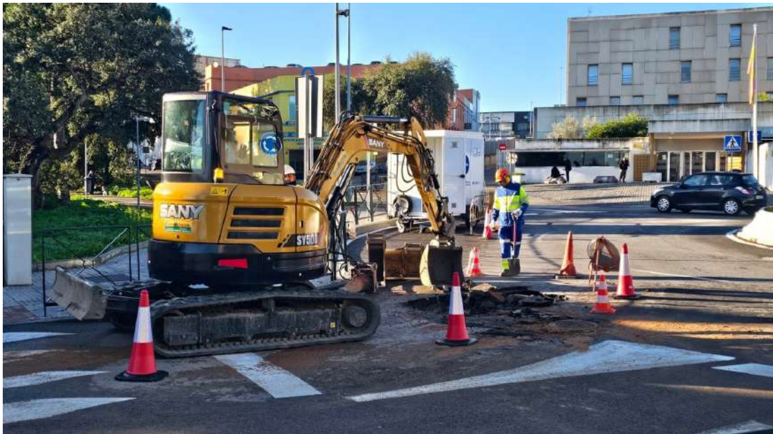
La avería de agua, en la avenida Diputación. / Erasmo Fenoy
